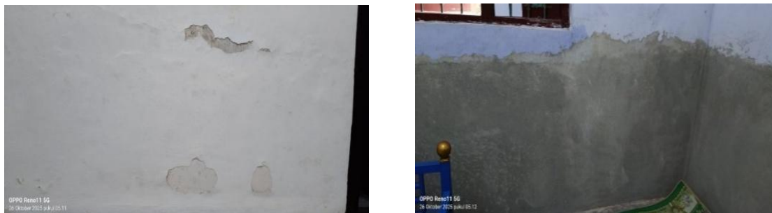
Gambar 3. Kondisi Permukaan Dinding Sebelum dan Setelah Perbaikan
