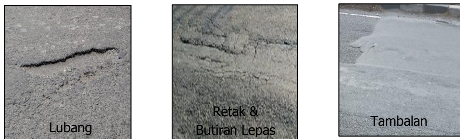
Gambar 4. Tipe Kerusakan Perkerasan Jalan
