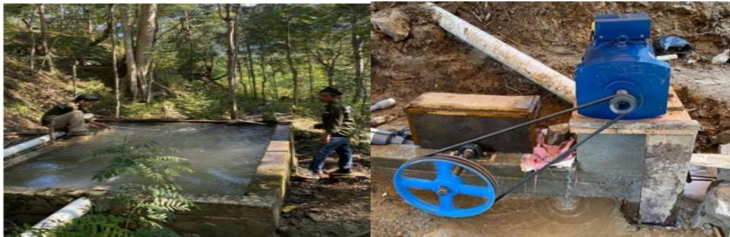
Gambar 3. Kondisi Generator AC Sinkron dan Reservoir PLTMH Garassik
