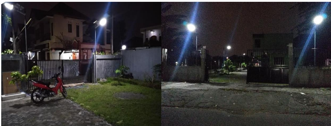
Gambar 6. Lampu penerangan jalan dengan tenaga surya yang telah terpasang di pintu masuk sampai ke dalam kompleks MIC Banguntapan.
